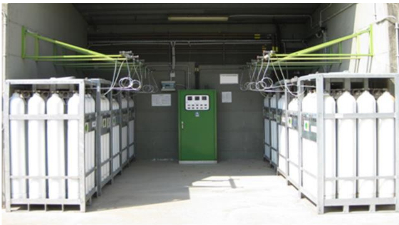
Centrale di erogazione in bombole
